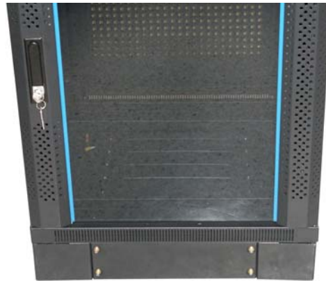
Podstavec nainstalovaný na rozvaděči TELCO
